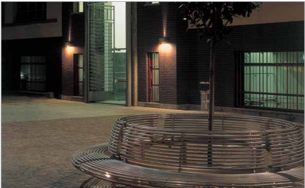
Impianto realizzato con l'installazione a parete di due apparecchi 3977.09.61 con l'uso del riduttore di fascio INOX16 per diminuire l'angolo di apertura dell'emissione indiretta
