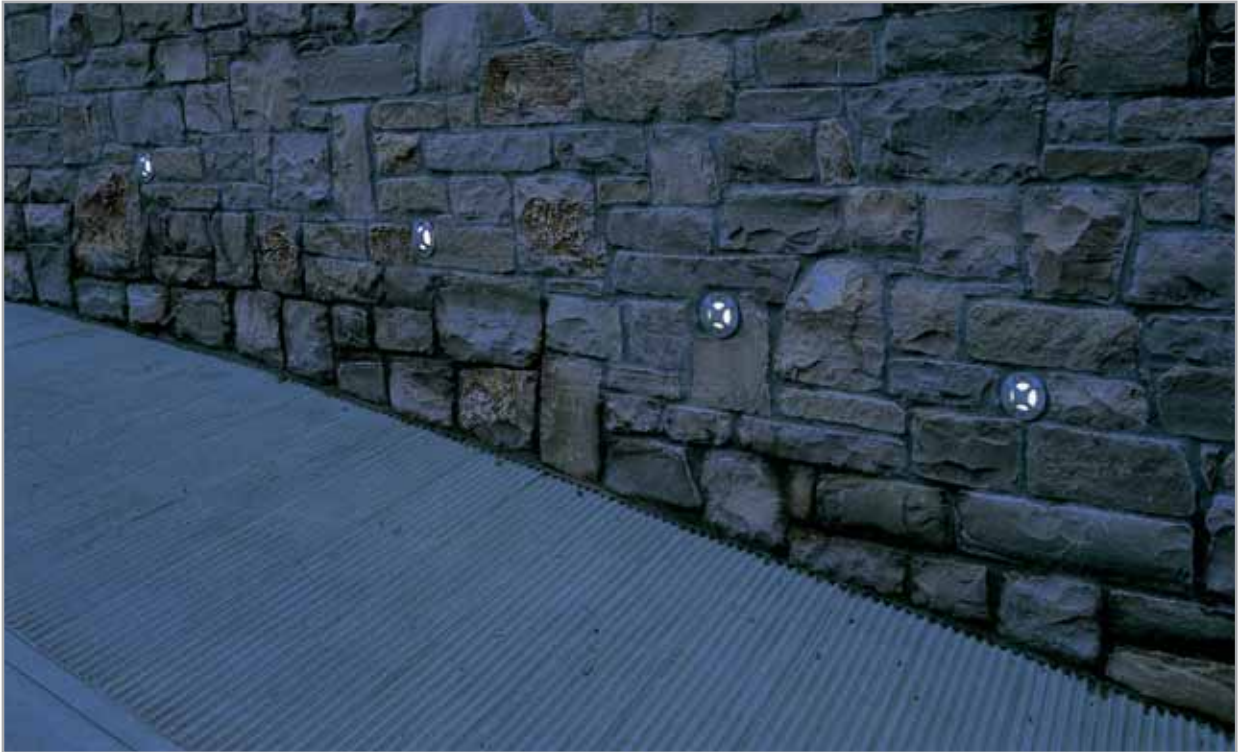
Installazione a parete di una serie di apparecchi cod. 3.965.09.60
