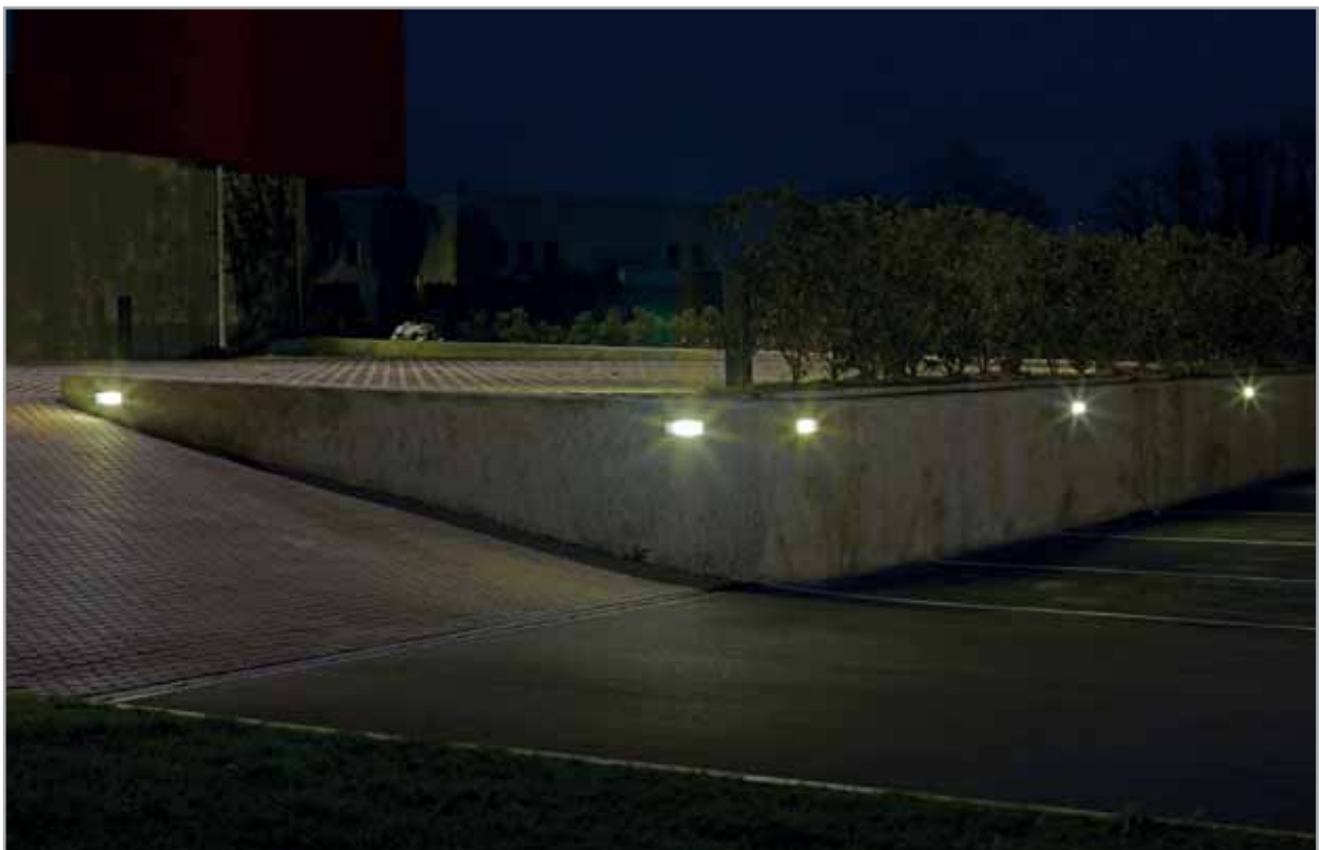
Installazione a parete di una serie di apparecchi cod. 3.651.02.61
