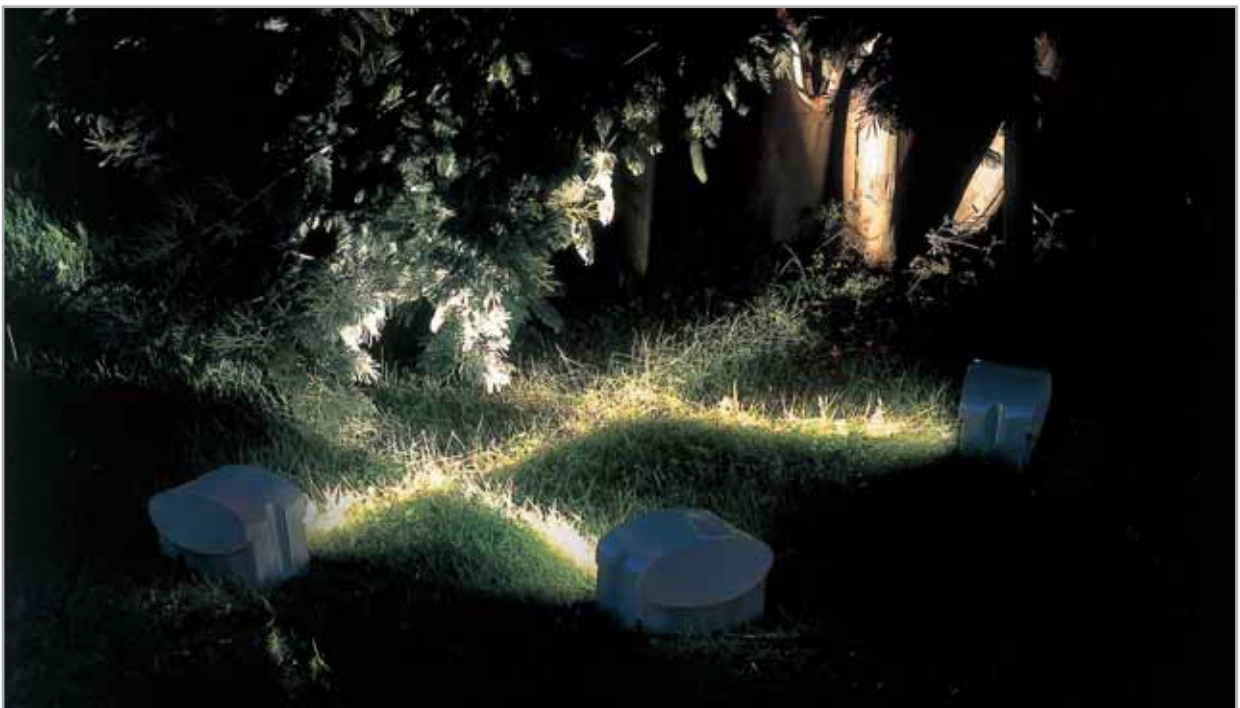
Impianto realizzato mediante l'uso di tre apparecchi cod. 3978.09.60 con accessorio per emissione singola INOX17. Installazione al suolo con creazione di un particolare effetto decorativo
