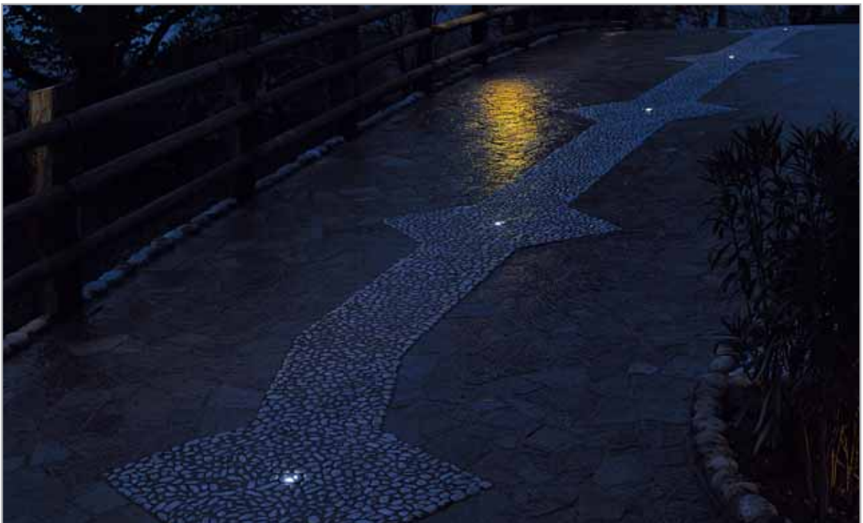
Installazione a terra di una serie di apparecchi cod. 3.965.09.60
