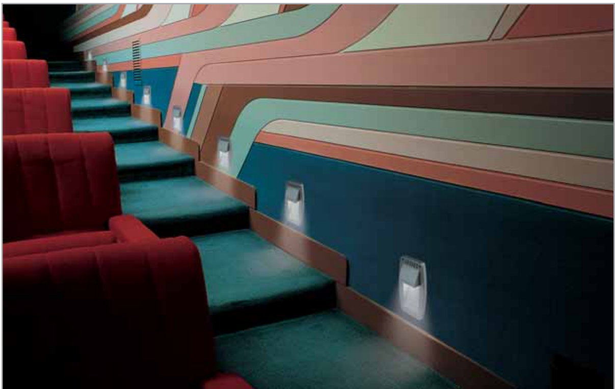
Installazione a parete di una serie di apparecchi cod. 3.654.09.61
